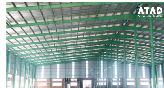
NHÀ MÁY SẢN XUẤT THIẾT BỊ ĐIỆN MẠNH PHƯƠNG
